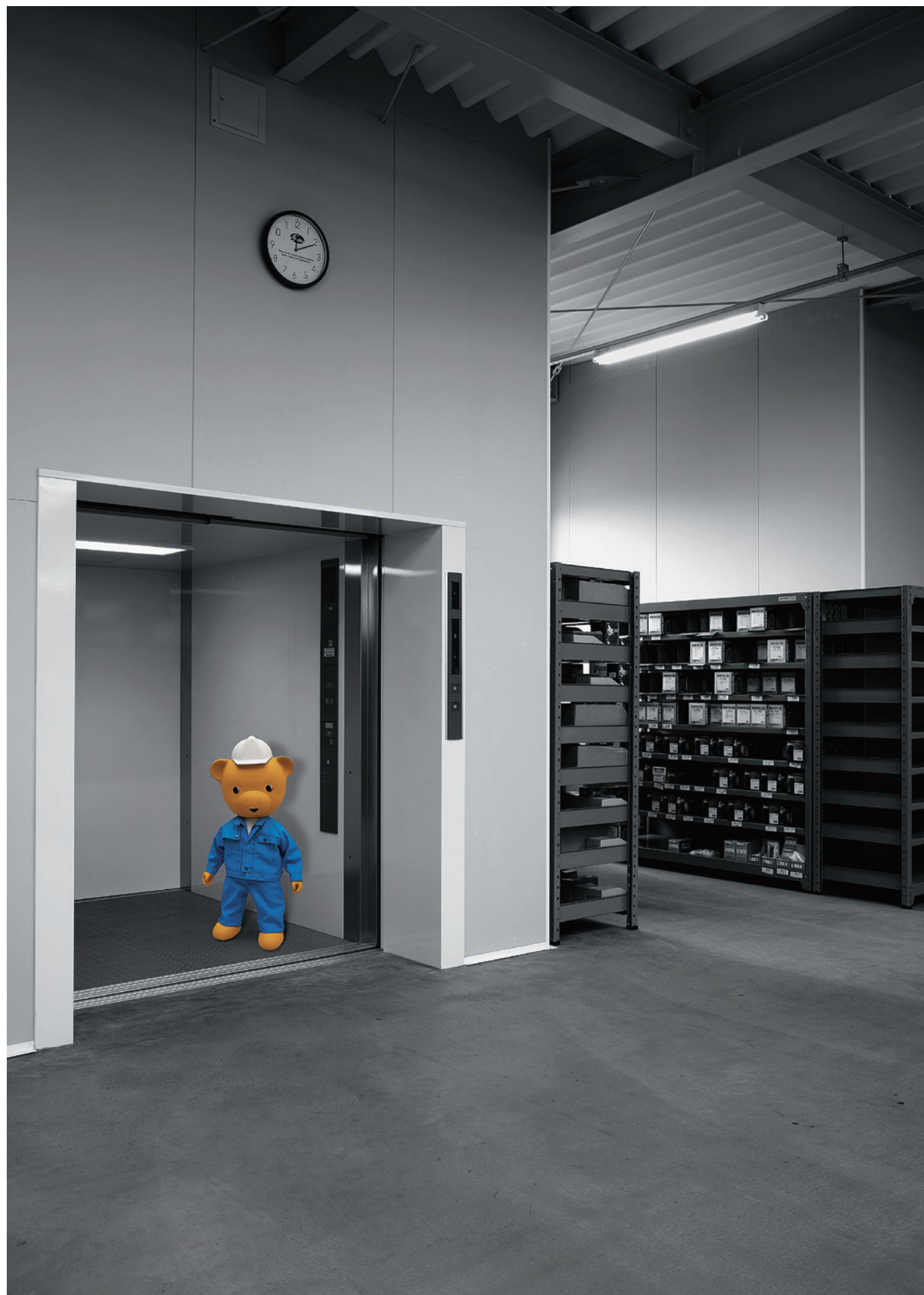
荷物用エレベーター マルチベアー
