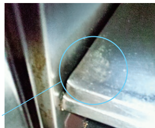
腐食して不潔なかごはカビや雑菌も発生
